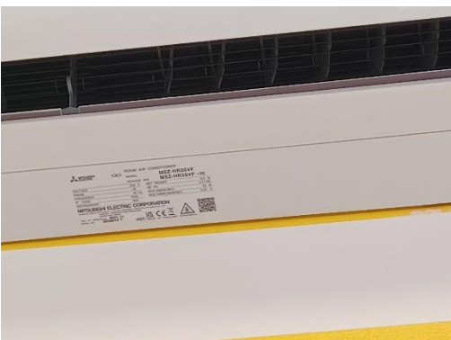
Unitat interior sistema de climatització
