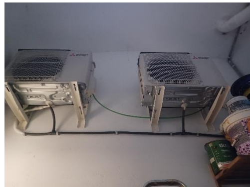
Unitats exteriors sistema de climatització
